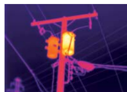
Overoppheting av poltransformator
